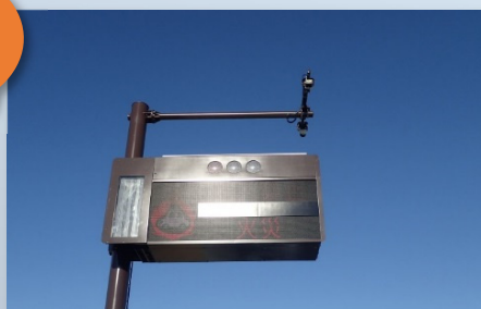
道路情報板支柱共架
